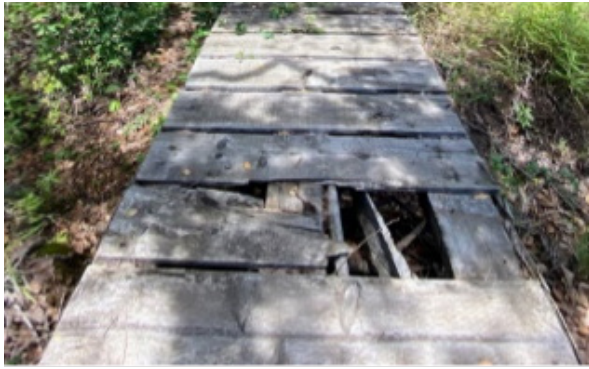
Figura 4 Puentes sin uso y deterioro.
