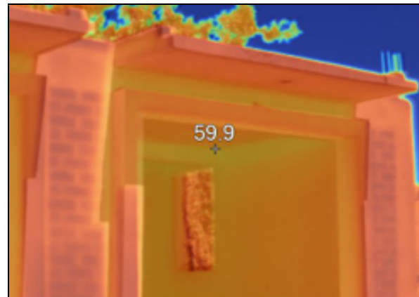
FIGURA 4. Temperatura marcada por cámara termográfica en losa de la edificación.
