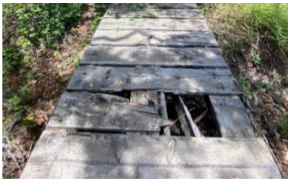
Figura 4 Puentes sin uso y deterioro.
